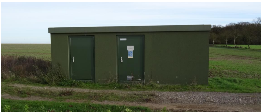
Illustration 3 : type de poste de livraison prévu au projet
